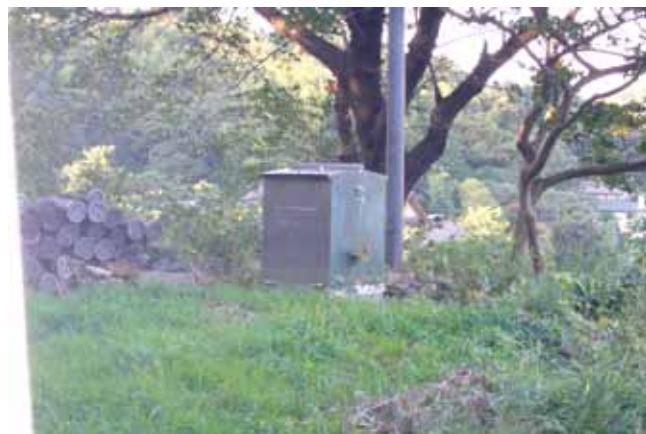
写真10 緑色に塗装された放水銃格納箱（C施設）
