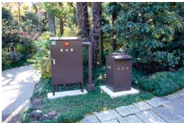
写真1 屋外消火栓と放水銃格納箱（A家）
