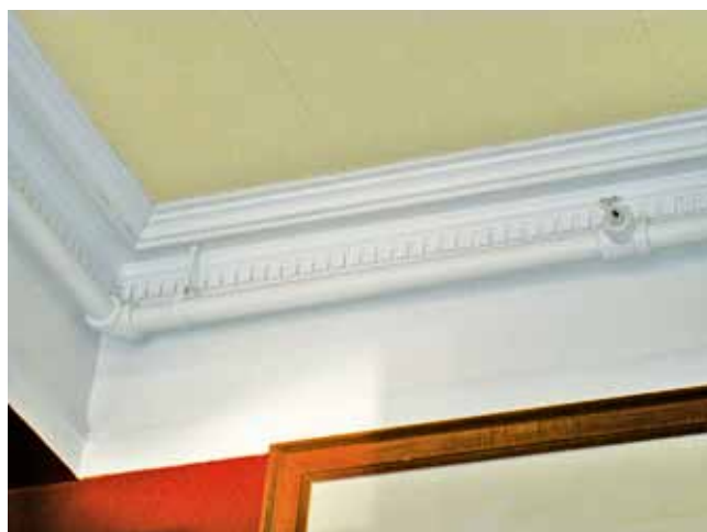
写真 12 景観と調和したスプリンクラー設備の露出配管（アメリカ）
