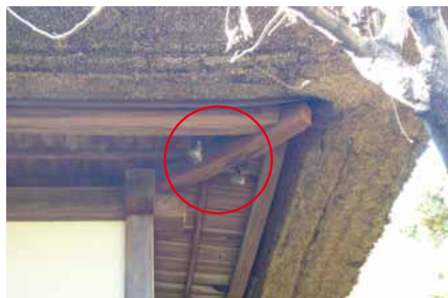
写真2 炎センサー（軒下）（A家）
