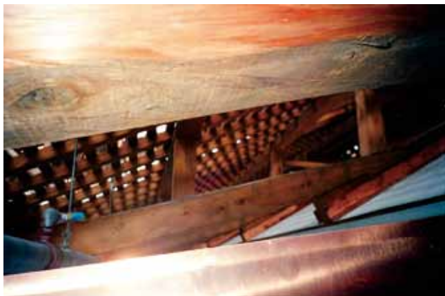
写真 13 小屋裏内ドレンチャー（D寺）
