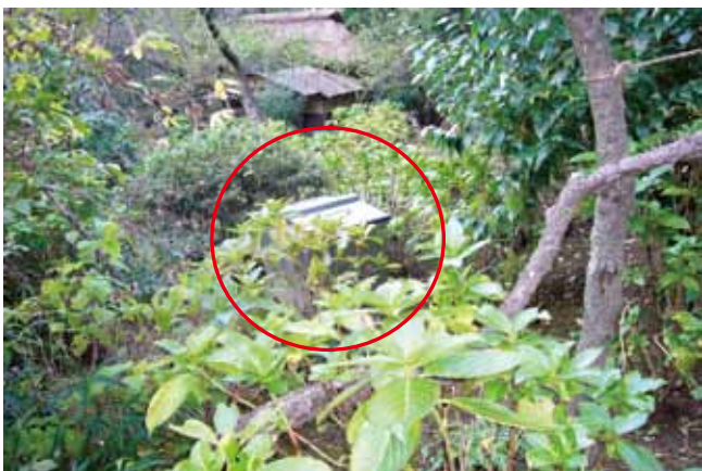
写真9 植栽内に設置された放水銃（C施設）
