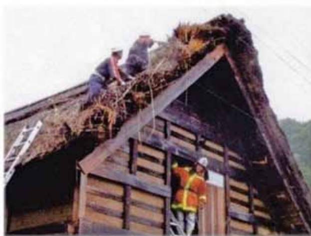
写真 16 植物性屋根の破壊消防（F集落）
