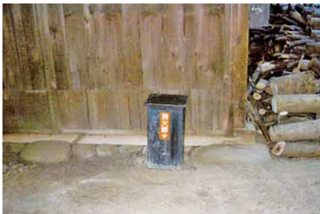
写真7 消火器（C施設）
