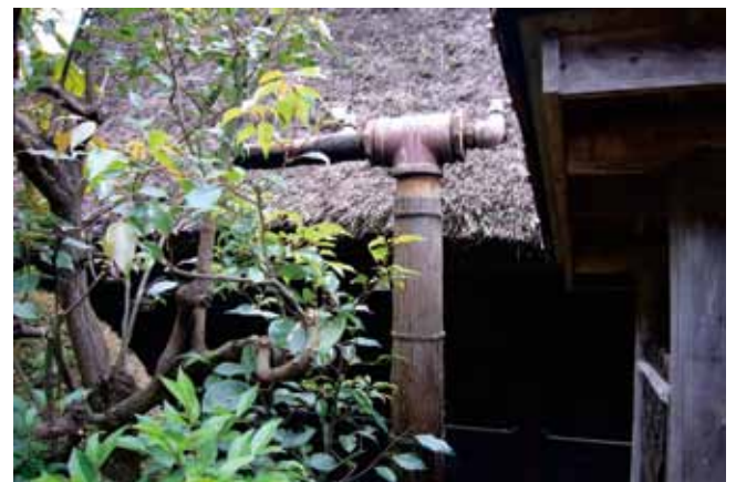
写真6 ドレンチャー（B施設）
