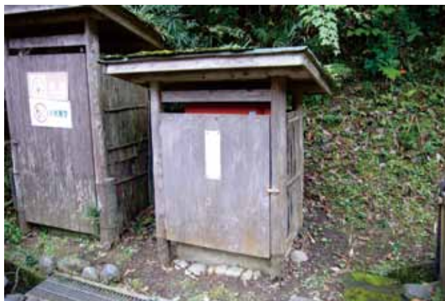
写真5 屋外消火栓（B施設）
